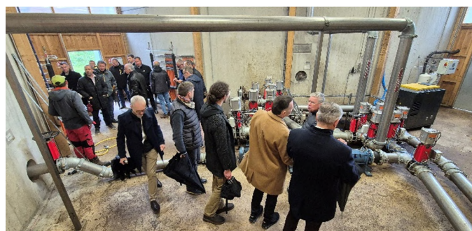
Le système de pompes d'alimentation des cuves
